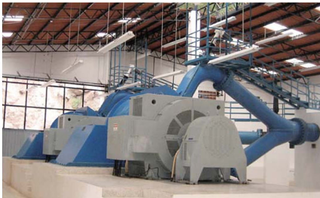
Φωτ. 6.9. Μετά τη μεταφορά και συναρμολόγηση των επί μέρους τμημάτων, κατασκευάζεται το οικοδόμημα, που στεγάζει την όλη εγκατάσταση. Οι σκάλες πάνω από τους αγωγούς οδηγούν στο ρυθμιστή της δέσμης του νερού.
