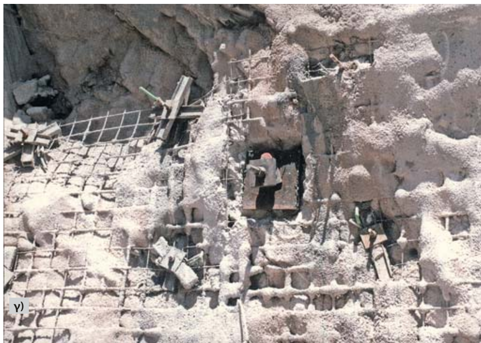
Φωτ. 5.5.21α,β,γ. Αγκύρωση πρανών. (α) Το αγκύριο πακτώνεται στο βάθος του διατηρήματος. (β) Στη συνέχεια τοποθετείται η μεταλλική πλάκα και (γ) Το πρανές καλύπτεται από μεταλλικό πλέγμα και στην επιφάνεια εφαρμόζεται το εκτοξευόμενο σκυρόδεμα.
