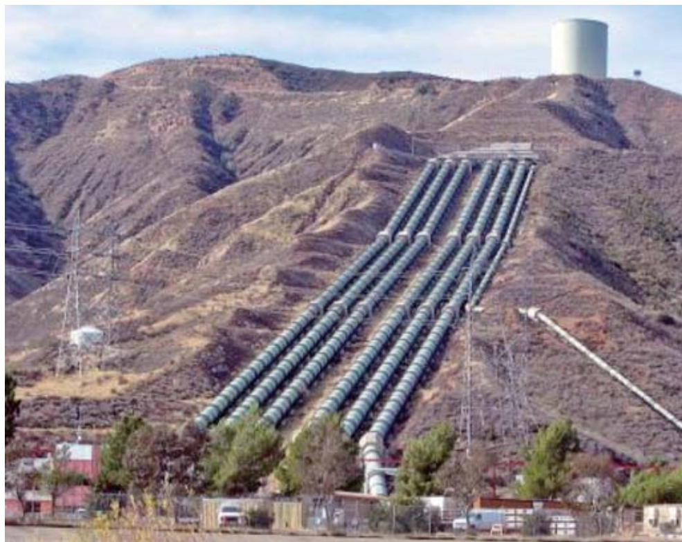
Φωτ. 1.9. Υδροηλεκτρική εγκατάσταση. Στην κορυφή φαίνεται η δεξαμενή ανάπαλσης, και στη συνέχεια οι 6 σωληνώσεις προσαγωγής.
