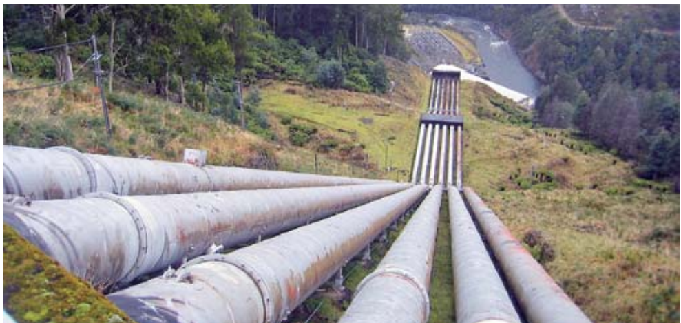
Φωτ. 1.12. Οι αγωγοί προσαγωγής του νερού στον υδροηλεκτρικό σταθμό αγκυρώνονται με σκυρόδεμα ανά αποστάσεις 100 ÷ 150 m. Στα μεταξύ των αγκυρώσεων διαστήματα οι αγωγοί πατάνε σε σάγματα.
