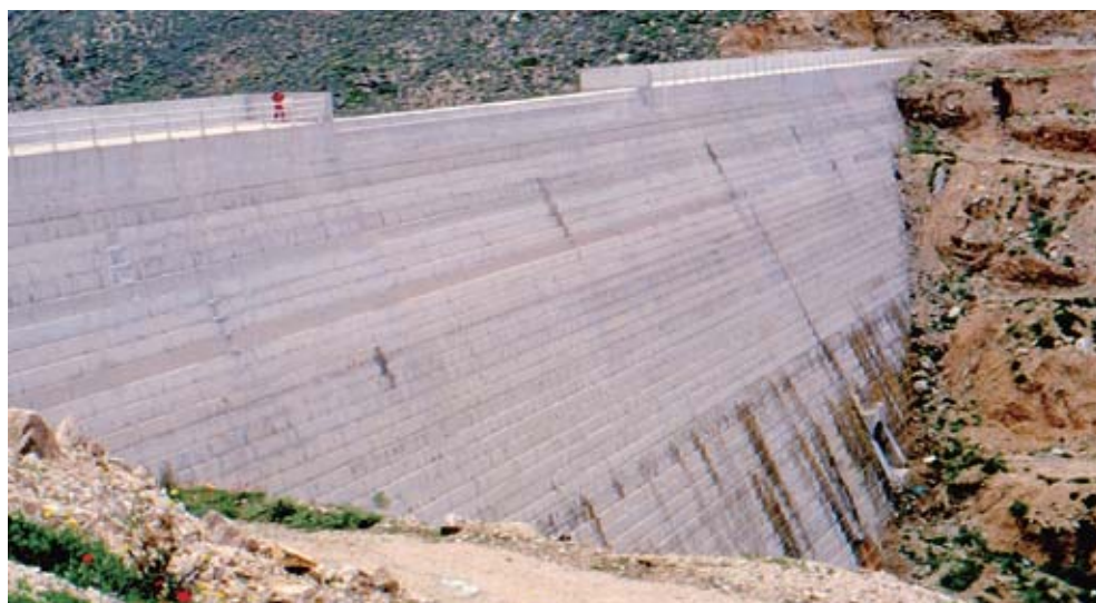
Φωτ. 7.13. Το φράγμα της Άνω Μεράς στη Μύκονο είναι φράγμα σκληρού επιχώματος (hard fill). Κατασκευάστηκε το 1997, για να καλύψει τις ανάγκες του νησιού σε πόσιμο και αρδευτικό νερό. Στη μέση έχει αφεθεί μια σκάφη για την ελεύθερη υπερχείλιση.
