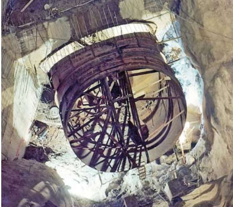
Φωτ. 6.2. Μεταφορά με γερανό ενός γωνιακού δαχτυλιδιού του αγωγού προσαγωγής του νερού στο ΥΗ Σταθμό της Σφηκιάς.
