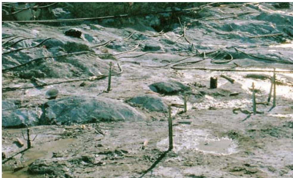
Φωτ. 5.5.12. Στην επιφάνεια που έγινε η διάχυση τσιμεντοπολτού, ρίχνεται το σκυρόδεμα με φορτωτή ή ατέρμονα ταινία, που εξομαλύνει τις έντονες ανωμαλίες της επιφάνειας. Πριν από τη στρώση, τοποθετούνται πλαστικοί σωλήνες σαν καλούπια για να τοποθετηθούν μετά τη σκλήρυνση του σκυροδέματος τα μηχανικά racker για την εφαρμογή των τσιμεντενέσεων επαφής.
