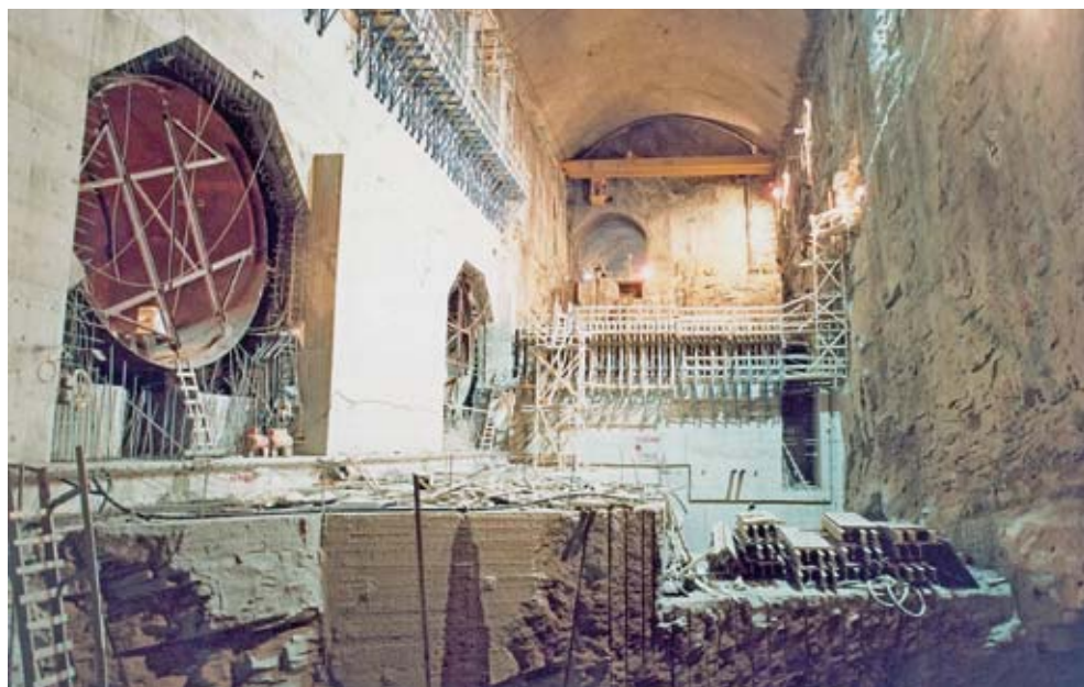
Φωτ. 6.1. Μία φάση από την κατασκευή του Υδροηλεκτρικού Σταθμού Στράτο. Διακρίνονται αριστερά οι αγωγοί μεταφοράς του νερού στις τουρμπίνες. Οι αγωγοί μεταφέρονται στη θέση του έργου κατά τμήματα (δαχτυλίδια) και συγκολλούνται επί τόπου, ενώ στη συνέχεια σκυροδετούνται εξωτερικά.
