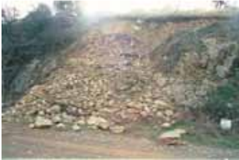
Εικόνα 1.4.1: Κατακύλιση υλικών λόγω βαρύτητας
