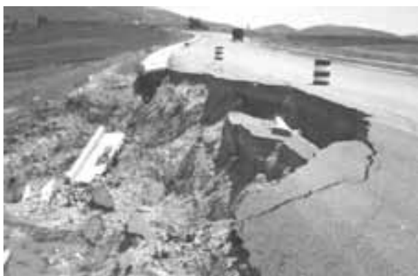
Σχήμα 1.35: Αστοχία οδικού επιχώματος και πρανούς - Συνδυασμός σεισμικών αδρανειακών φορτίων και μείωσης της διαθέσιμης διατμητικής αντοχής στρώσης μαλακής αργίλου (Σεισμός Κοζάνης, 13/05/1995, M_s = 6.6 ).
