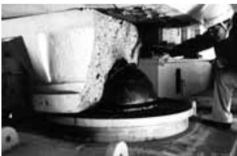
Σχήμα 1.14: Αστοχία σφαιρικού εφεδράνου (Σεισμός Kobe, 1995).
