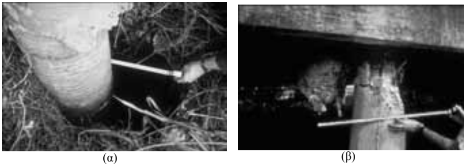
Σχήμα 1.39: (α) Απώλεια πλευρικής στήριξης εδάφους (δημιουργία κενού μεταξύ πασσάλου - εδάφους) και (β) Καμπτική αστοχία κεφαλής πασσάλου (Σεισμός Loma Prieta, 1989).
