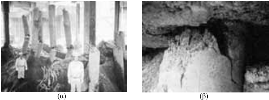
Σχήμα 1.40: (α) Διατμητική αστοχία πασσάλων ως αποτέλεσμα της έντονης εδαφικής διαστρωμάτωσης και (β) Αστοχία πασσάλων λόγω πλευρικής εξάπλωσης ρευστοποιήσιμου εδαφικού σχηματισμού (Σεισμός Kobe, 1995).
