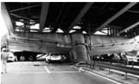
Σχήμα 1.13: Κατάρρευση βάρου - Αστοχία θεμελίου (Σεισμός Kobe, 1995).
