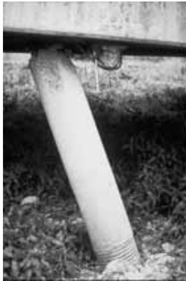
Σχήμα 1.17: Αστοχία του κόμβου καταστρώματος – πασσάλου. Η σύνδεση πασσάλου - κεφαλόδεσμου και πασσάλου – καταστρώματος όταν ο πάσσαλος θεμελίωσης προεκτεινόμενος καθ' ύψος εκτελεί και χρέη βάθρου είναι από τα πλέον ευπαθή σημεία της κατασκευής (Σεισμός Loma Prieta, 1989).
