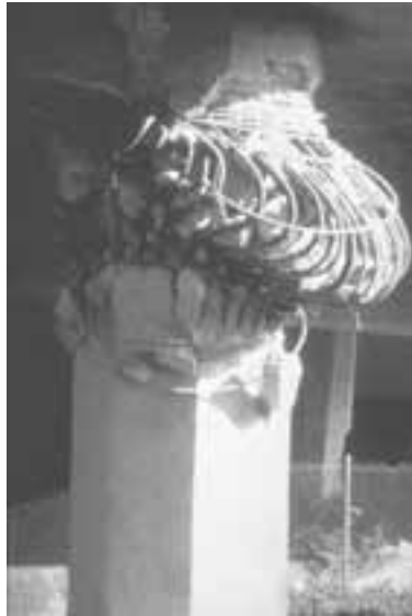
Σχήμα 1.24: Αστοχία στύλου κάτω από τη θλιβόμενη ζώνη (Bull Creek Canyon Channel Bridge, SR118 - Σεισμός Northridge, 1994).
