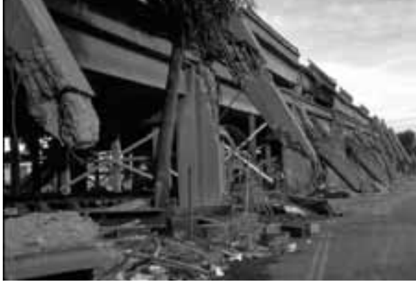
Σχήμα 1.16: Η γέφυρα I-880 Cypress Viaduct μετά την κατάρρευση του άνω καταστρώματος (Σεισμός Loma Prieta, 1989).
