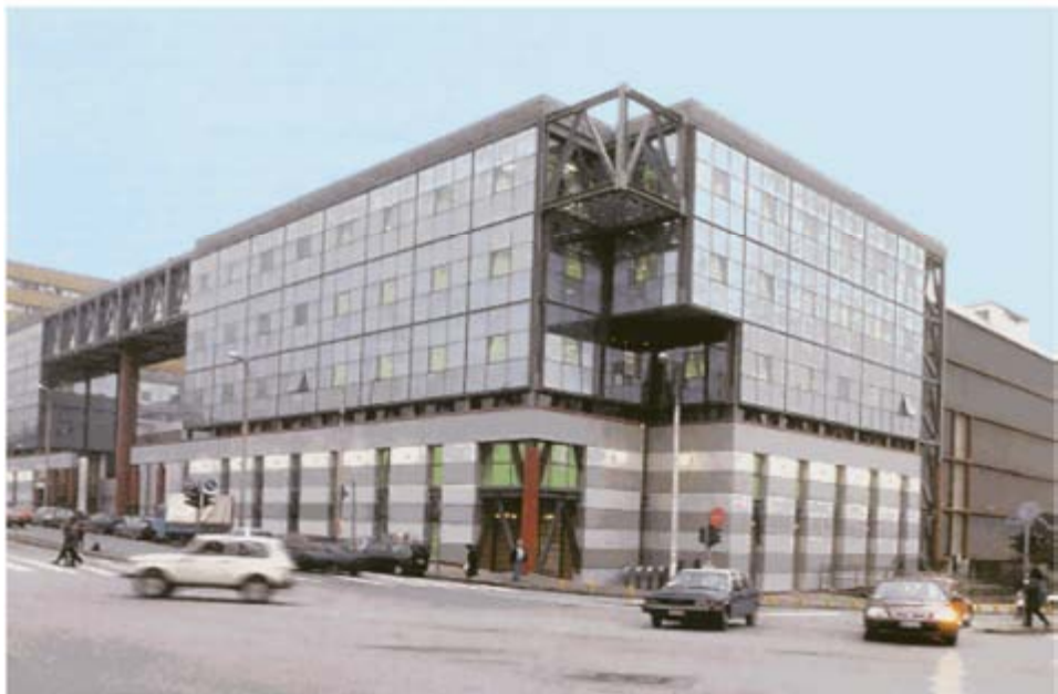
Σχήμα 1.5.9: Το κτίριο της Σχολής Θετικών Επιστημών Α.Π.Θ. στη Θεσσαλονίκη στη φάση κατασκευής του (άνω) και ολοκληρωμένο στη τελική μορφή του (κάτω)
