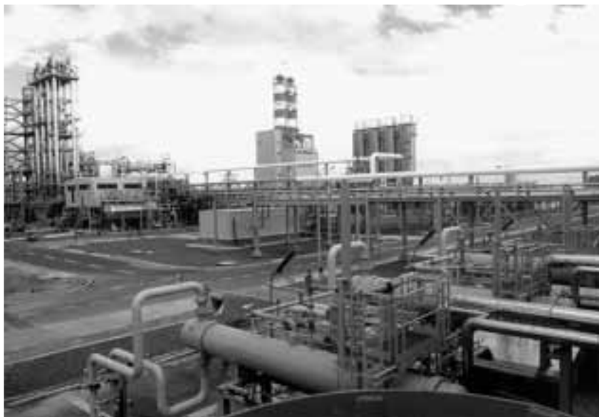
Εικόνα 1.3.3. Μονάδα παραγωγής πολυπροπυλενίου στο βιομηχανικό συγκρότημα Θεσσαλονίκης “Ελληνικά Πετρέλαια Α.Ε.”. Διακρίνεται, αριστερά ο αντιδραστήρας, στο κέντρο οι extruders κοκκοποίησης του προϊόντος και δεξιά τα σιλό αποθήκευσης.
